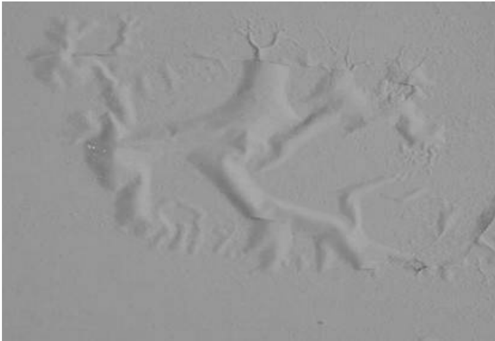
Рис. 4.2. Фотография фасада здания по улице Циолковского, г. Пенза, после первого года эксплуатации покрытия
