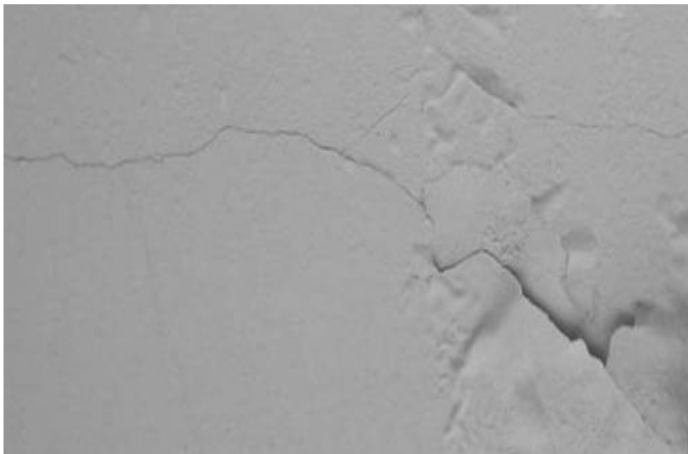
Рис. 4.3. Фотография фасада здания по улице Циолковского, г. Пенза, после трех лет эксплуатации покрытия
