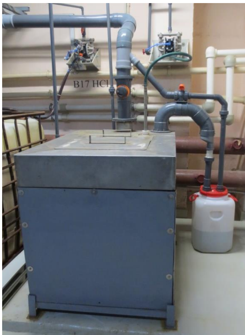
Рисунок 5 – Общий вид реактора для обезвреживания высококонцентрированных отработанных медно-аммиачных травильных растворов абсорбера
