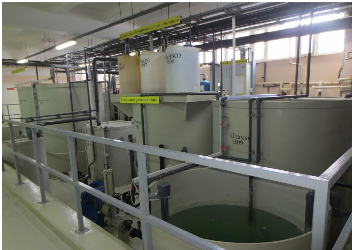
Рисунок 3 – Общий вид локальных очистных сооружений АО «НПП «Рубин»»
