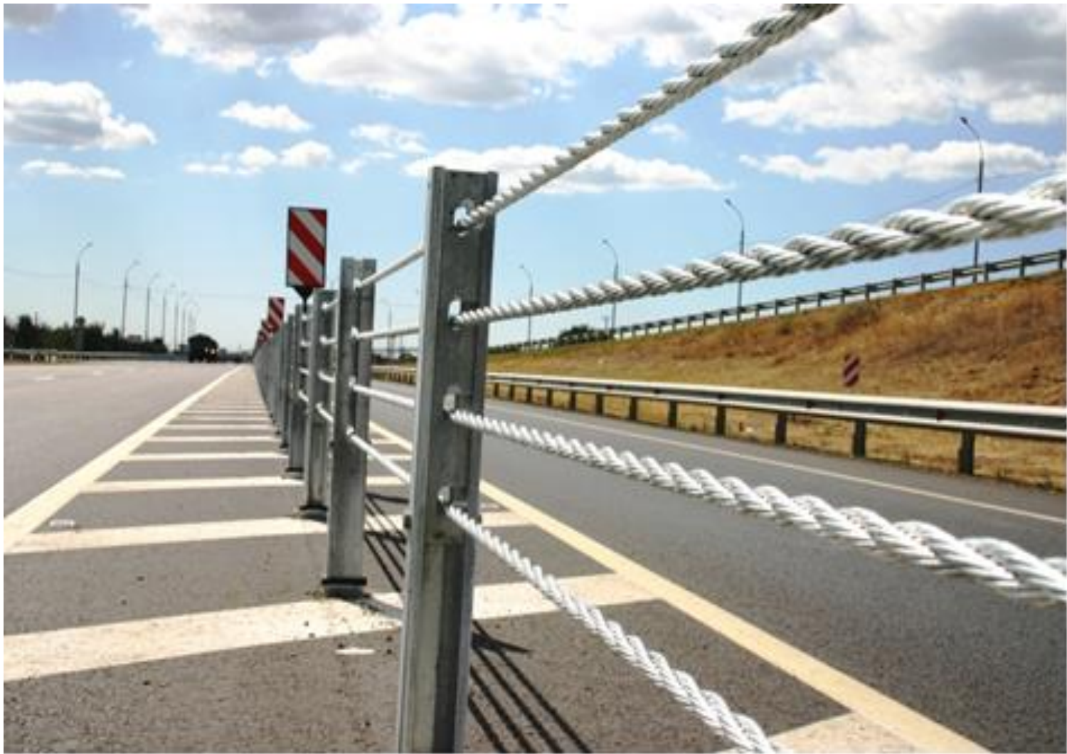
Тросовое ограждение применяемое в РФ
