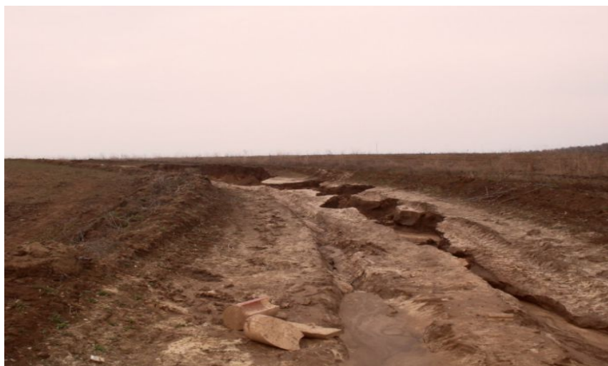
Рисунок 8 - Промоина по колее грунтовой дороги на склоне
