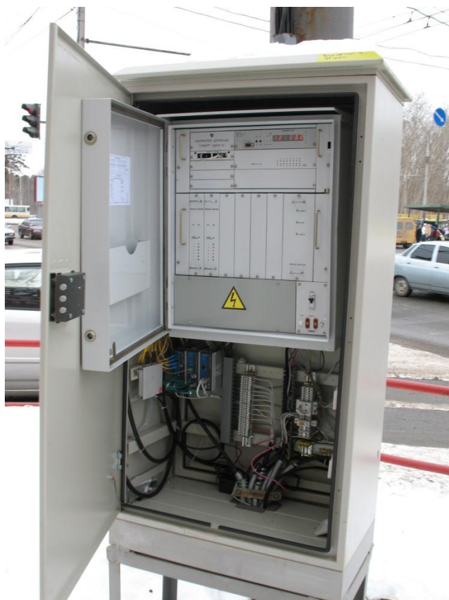
Рисунок 3.1 – Внешний вид дорожного контроллера СПЕКТР - КДСФ
