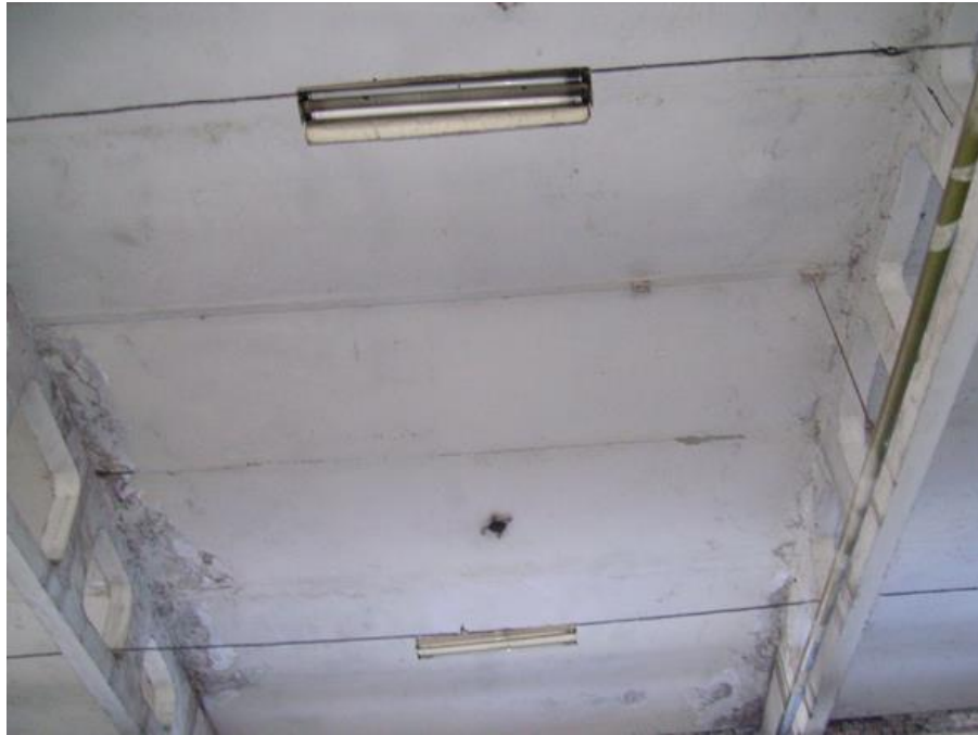
Рис. 1.3. Намокание приопорных участков плит покрытия в осях 4-5 со стороны ряда А. Следы подтеков на стропильных балках.
