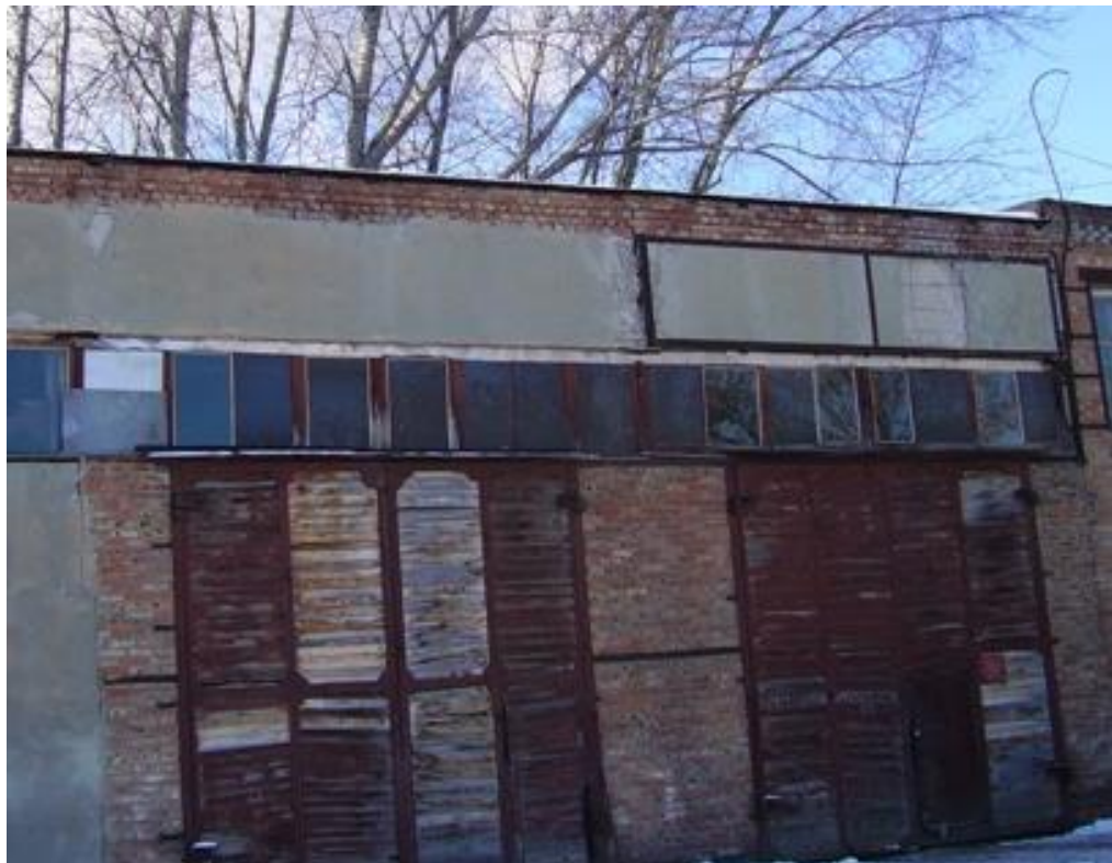
Рис. 1.7. Дефекты панелей между осями 8-9 по ряду А. Общий вид ленточного остекления и ворот здания автогааража
