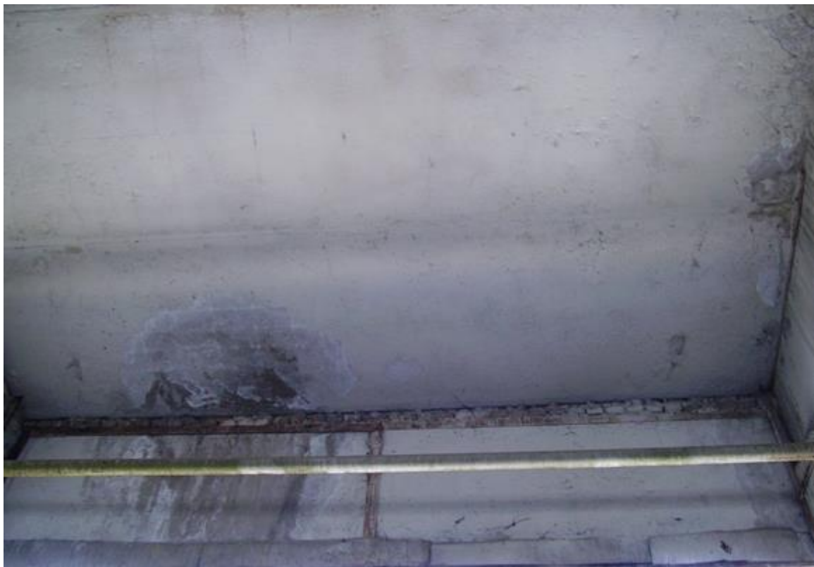
Рис. 1.6. Общий вид намокания плиты покрытия около ряда А в осях 8-9. Намокание опорных зон плит покрытия по оси 8 между осями 8-9, около ряда А. Следы подтеков на стропильной балке.
