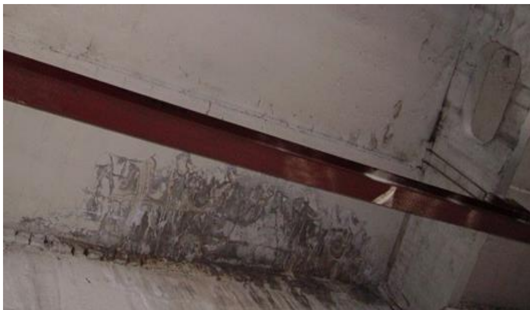
Рис. 1.2. Намокание панели покрытия по ряду Б в осях 4-5.
