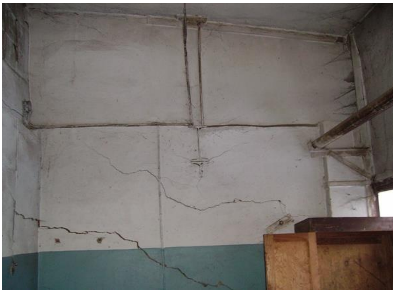
Рис. 1.8. Общий вид трещин в перегородке по оси 2.
