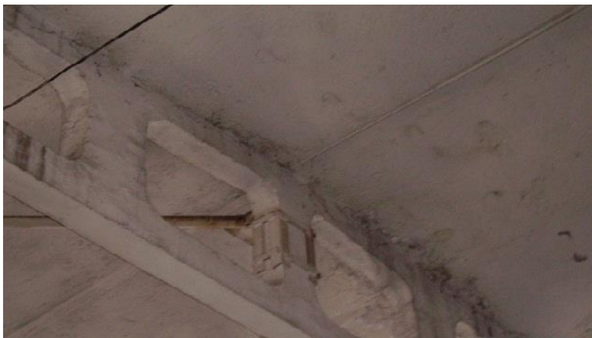
Рис. 1.1. Общий вид следов подтеков влаги на поверхностях стропильных балок
