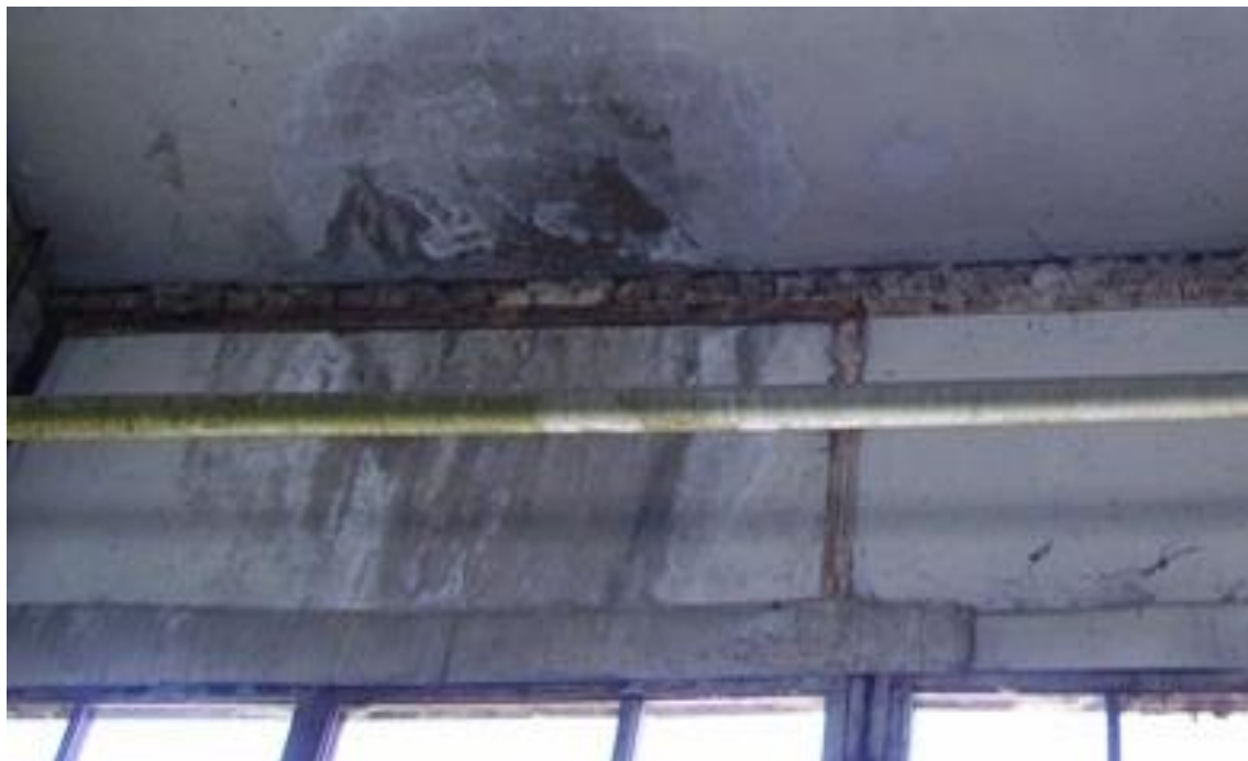
Рис. 1.7. Дефекты внутренней стороны панелей между осями 8-9 по ряду А.
