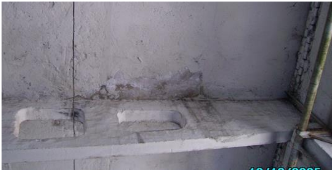
Рис. 1.4. Намокание опорных зон плит покрытия по оси 7 между осями 7-8, около ряда Б Следы подтеков на стропильных балках.
