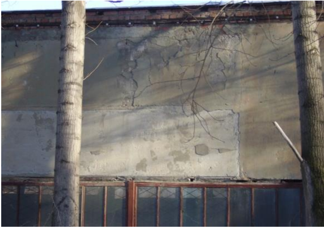
Рис. 1.7. Дефекты панелей между осями 6-7 по ряду Б. Общий вид ленточного остекления
