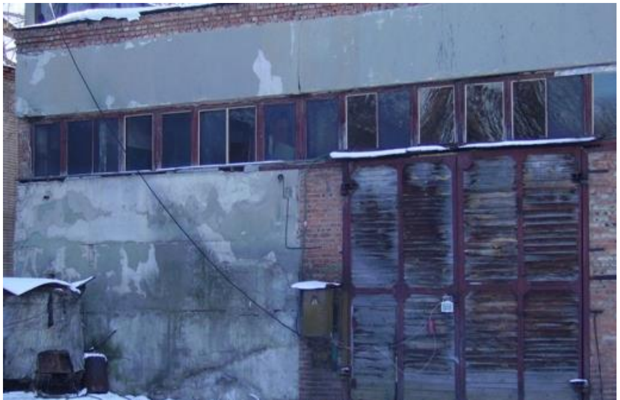
Рис. 1.7. Дефекты панелей между осями 1-2 по ряду А. Общий вид ленточного остекления и ворот здания автогаража
