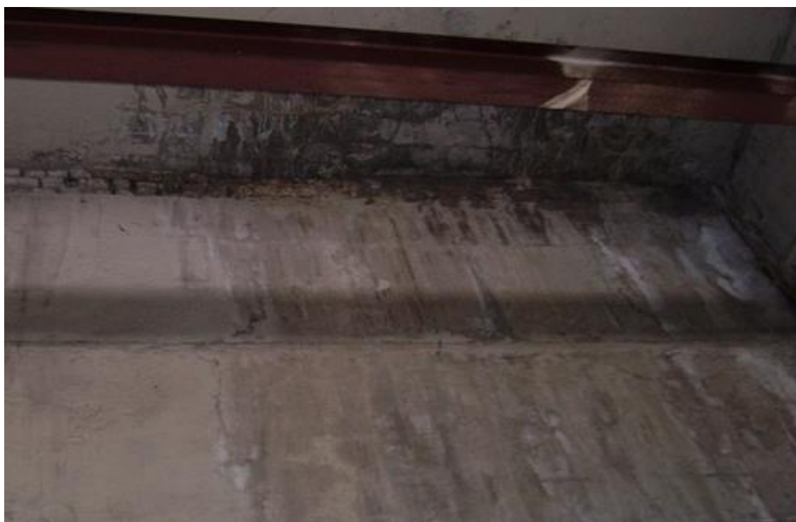
Рис. 1.7. Дефекты внутренней стороны панелей между осями 4-5 по ряду Б.
