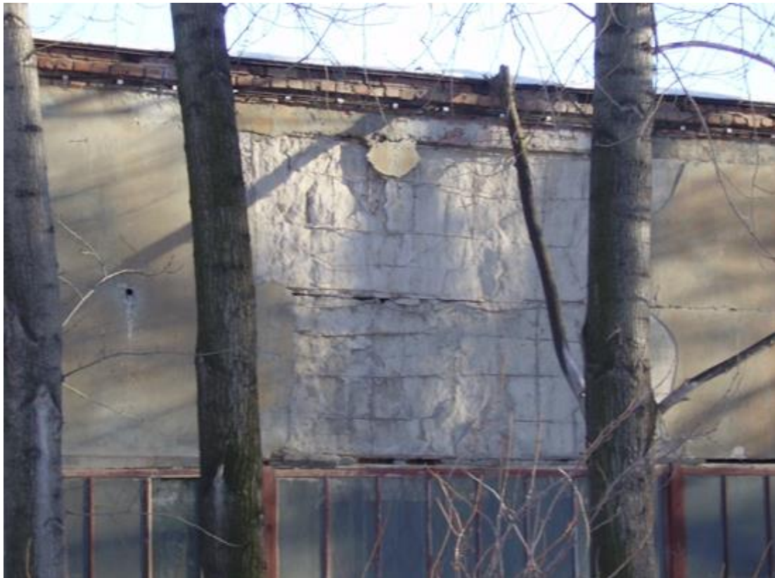
Рис. 1.7. Разрушение панелей между осями 4-5 по ряду Б. Общий вид ленточного остекления
