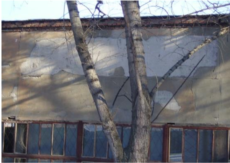
Рис. 1.7. Дефекты панелей между осями 2-3 по ряду Б. Общий вид ленточного остекления
