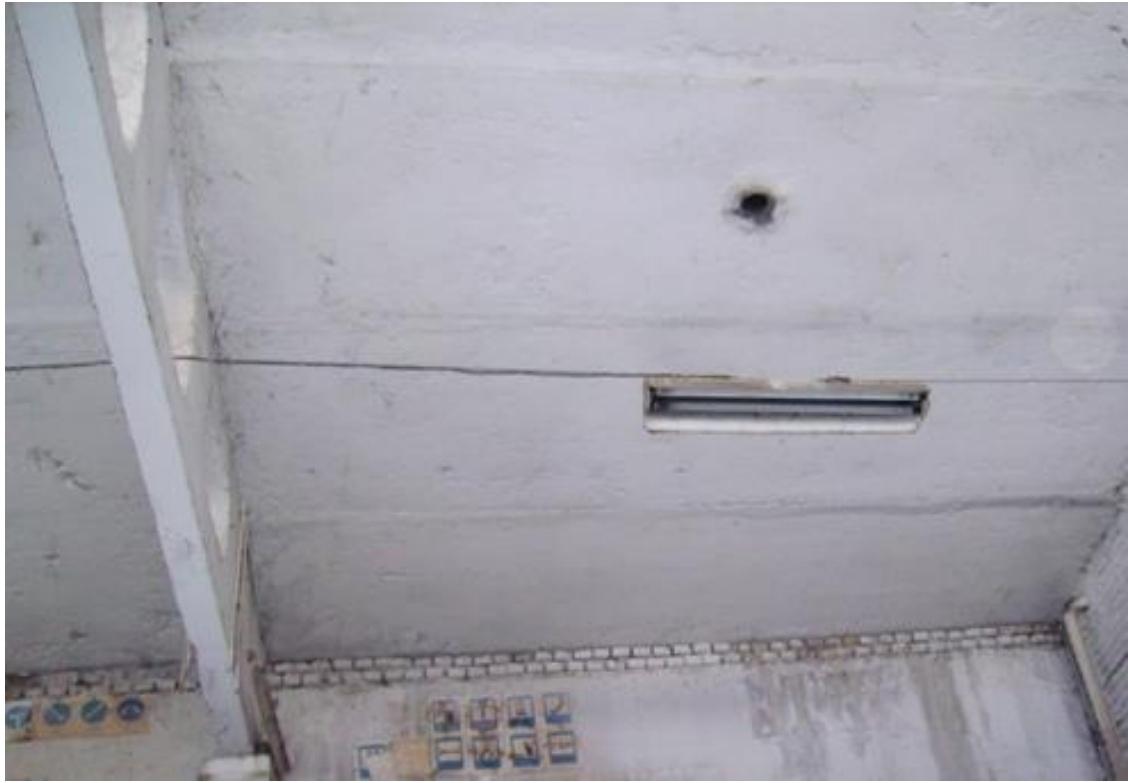
Рис. 1.5. Намокание опорных зон плит покрытия по оси 8 между осями 8-9, около ряда Б
