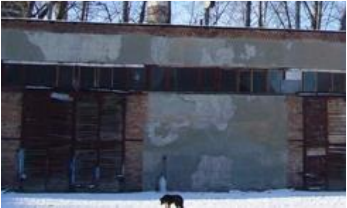
Рис. 1.7. Дефекты панелей между осями 6-7 по ряду А. Общий вид ленточного остекления и ворот здания автогаража
