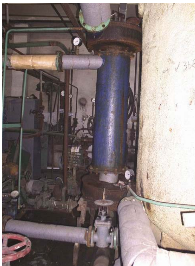
Рис.4.3. Общий вид ЭГДУ с рециркуляционными трубопроводами
