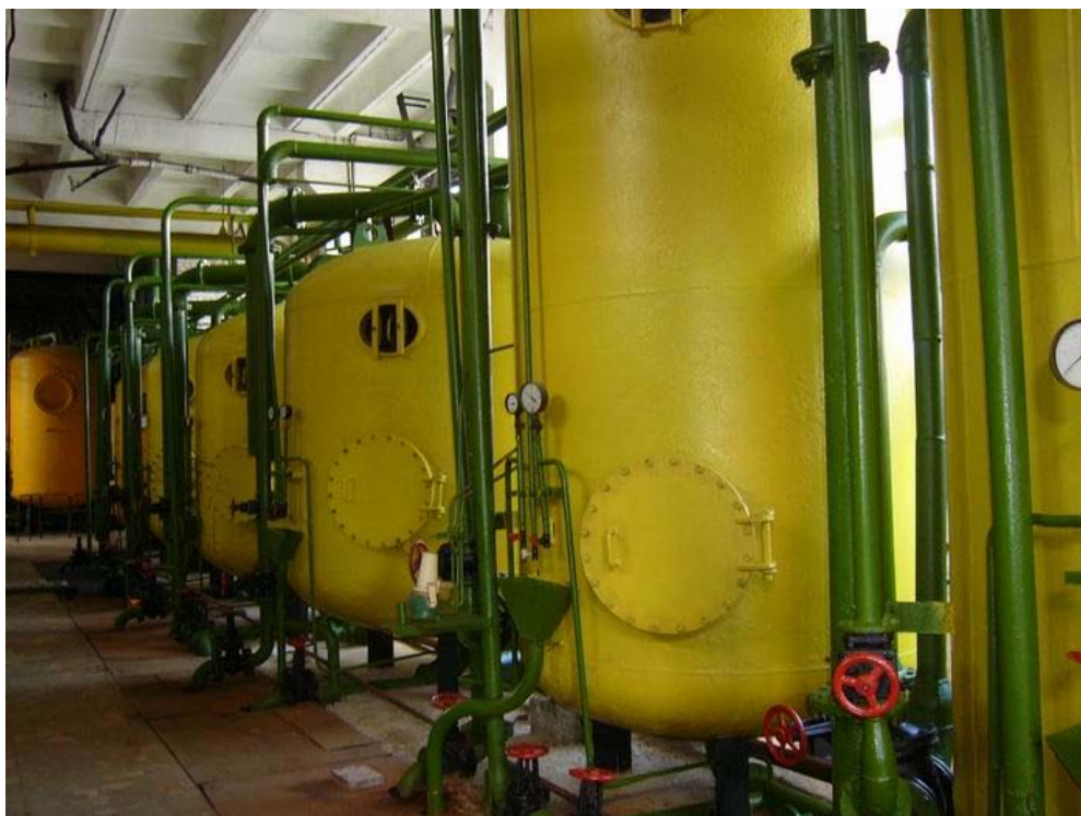
Рис.4.2. Общий вид фильтров на участке водоподготовки ТЭЦ-3 г.Кузнецка, Пензенской области
