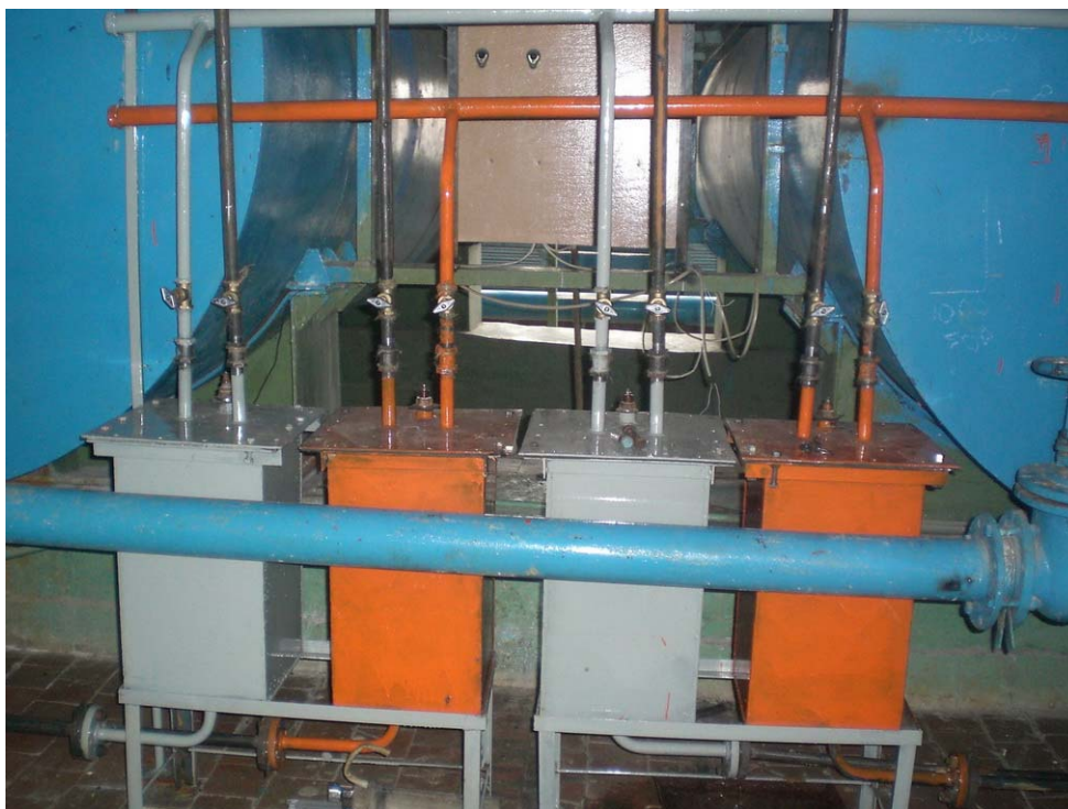
Рис. 5.5. Общий вид пневмобаков-дозаторов сульфида натрия и полиакриламида на локальных очистных сооружениях ОАО «Радиозавод»
