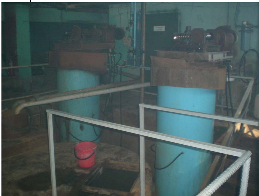
Рис. 5.7. Общий вид гальванокоагуляторов «ионофер» на локальных очистных сооружениях ОАО НПП «Рубин»
