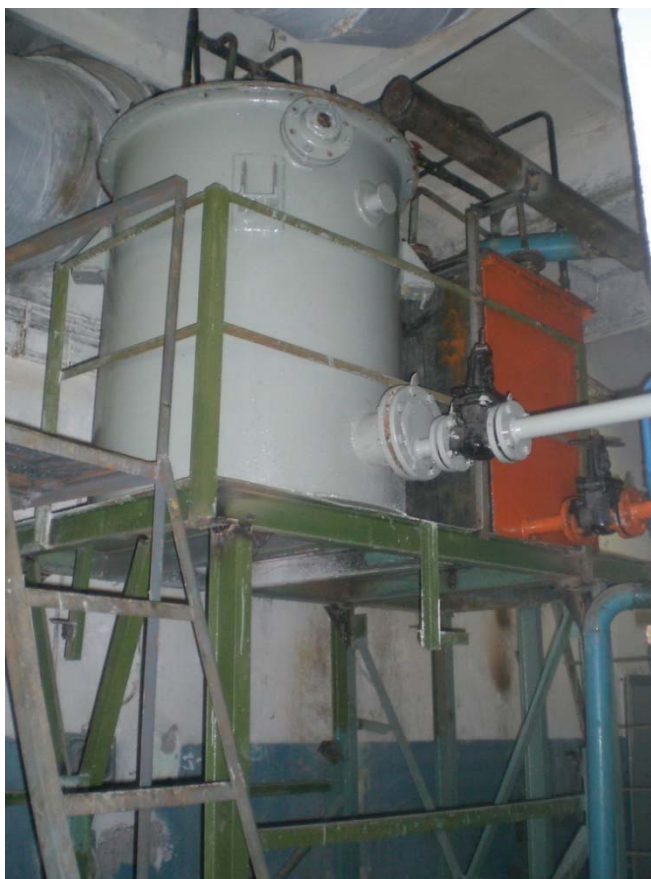
Рис. 5.4. Общий вид растворно-расходных баков сульфида натрия и полиакриламида на локальных очистных сооружениях ОАО «Радиозавод»
