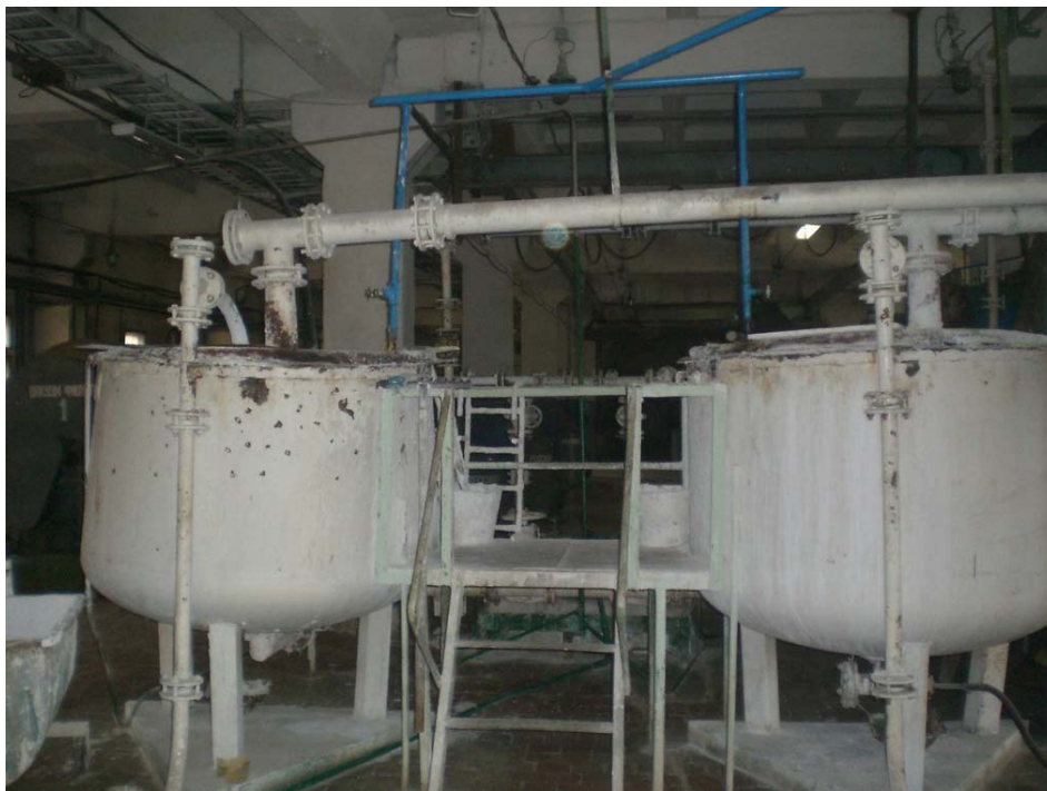
Рис. 5.2. Общий вид расходных баков известкового молока локальных очистных сооружений ОАО «Радиозавод»
