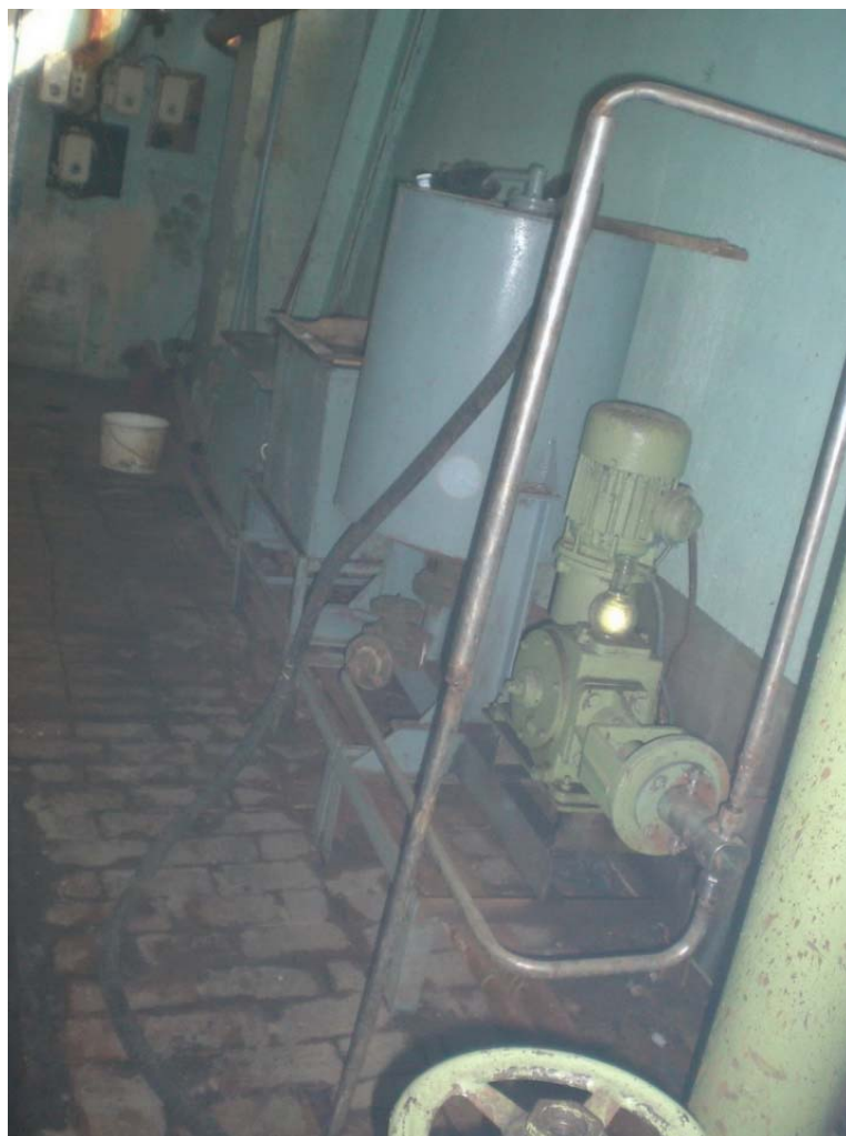
Рис. 5.10. Общий вид растворо-расходного бака сульфида натрия и насоса-дозатора на локальных очистных сооружениях ОАО НПП «Рубин»
