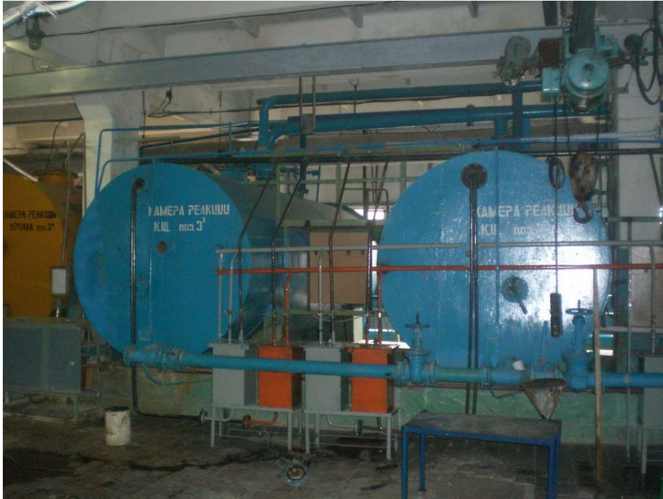
Рис. 5.1. Общий вид реакторов локальных очистных сооружений ОАО «Радиозавод»
