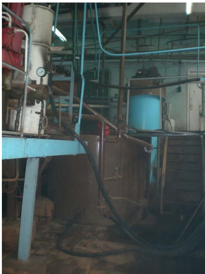
Рис. 5.8. Общий вид реактора локальных очистных сооружений ОАО НПП «Рубин»
