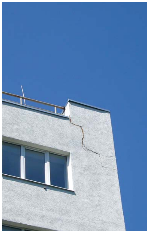
Рис. 4. Характерные трещины парапетов дома №3 по ул. Сузюмова
