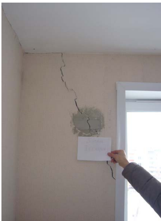
Рис. 3. Характерные трещины в несущих стенах дома №110 по ул. Новоселов
