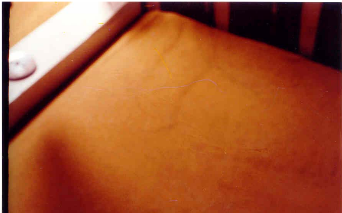
Рис. 4.20. Видимое разрушение основания (выпор поверхности)
