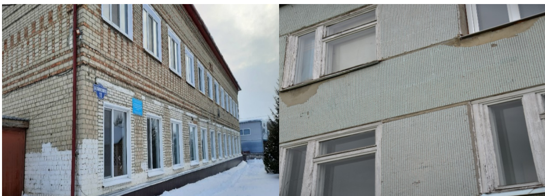
Рис. 9. Стены здания детского сада не соответствуют современным теплотехническим требованиям
