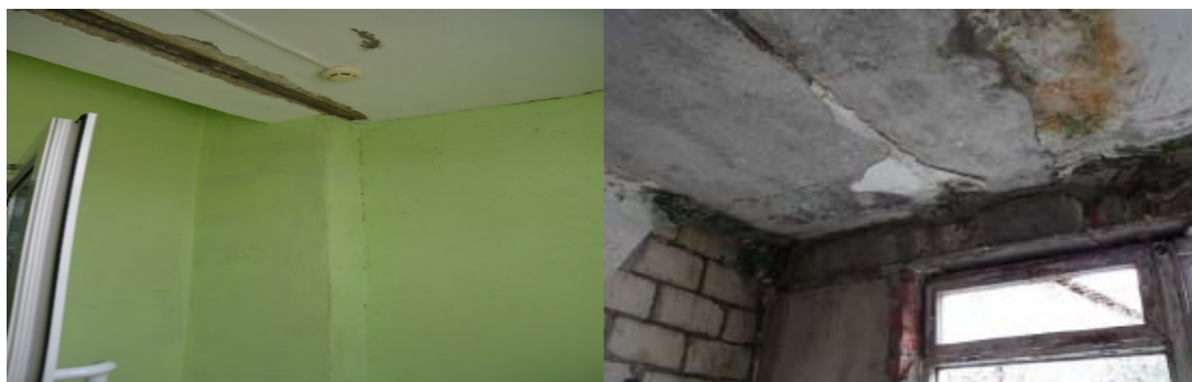
Рис. 8. В здании детского сада трещины в многопустотных конструкциях перекрытия, коррозия рабочих стержней и арматурных изделий
