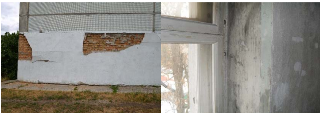
Рис. 7. Множественные следы намокания и разрушения поверхностного слоя стен
