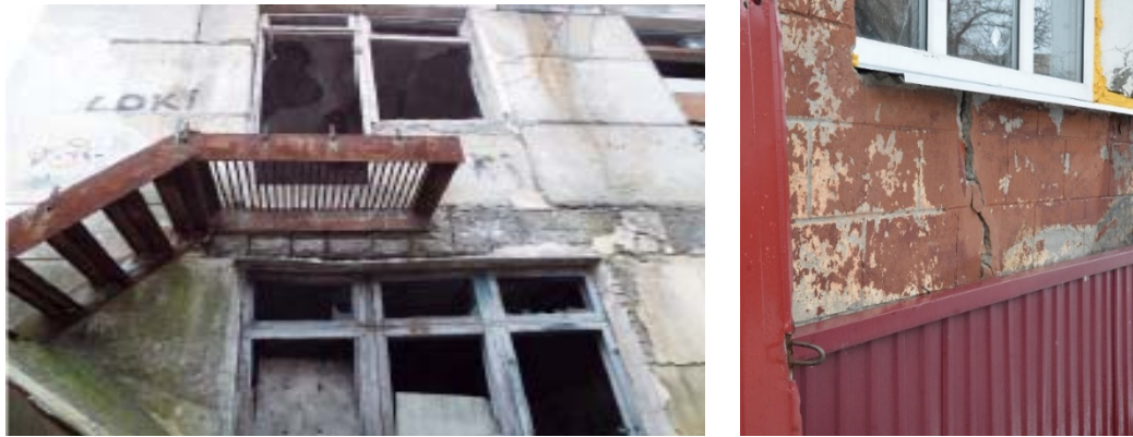
Рис. 10. В здании детского сада имеются локальные трещинообразования в несущих стенах, коррозия арматурных изделий, разрушение перемычек
