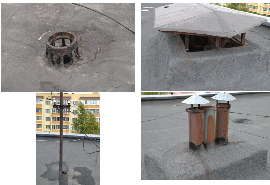
Рис. 5. На крыше здания детского сада водоприемные и вентиляционные устройства не соответствуют современным требованиям, кровельный материал имеет многочисленные повреждения
