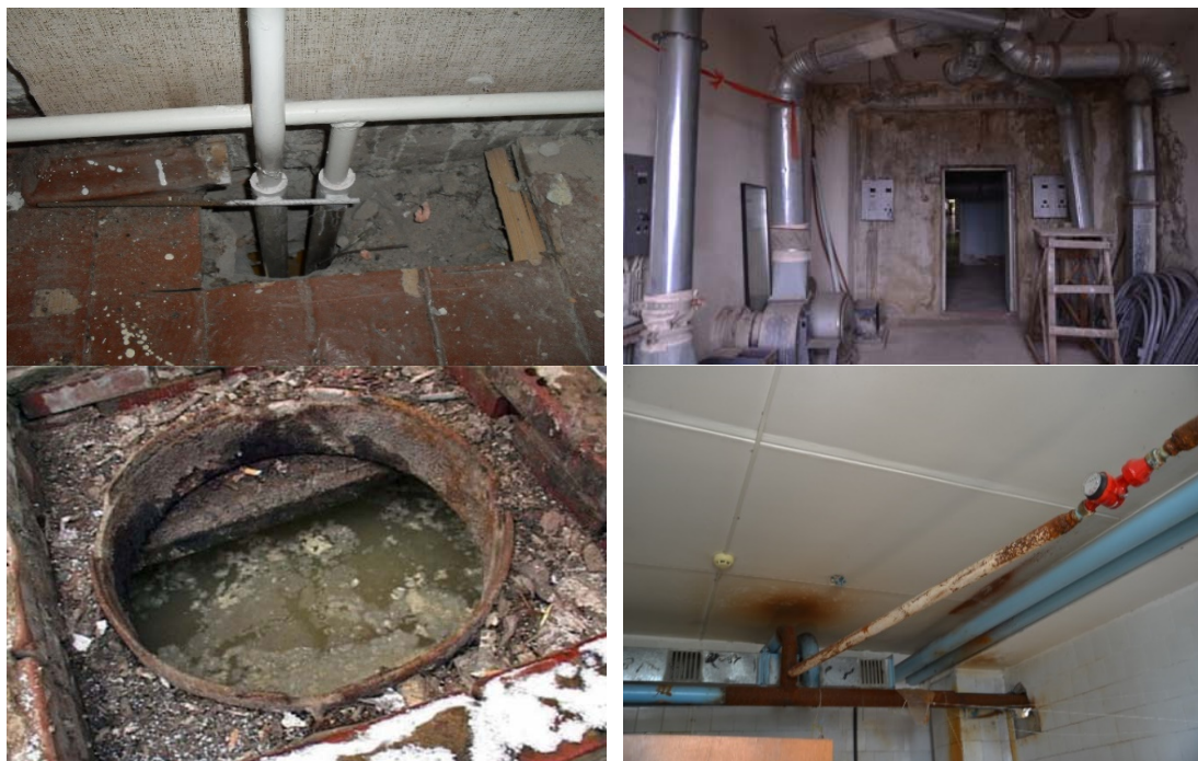
Рис. 4. При техническом обследовании инженерных систем здания детского сада выявлено: выпуски бытовой канализации выполнены из чугунных труб, трубопроводы имеют разрушения; сеть бытовой канализации имеет механические повреждения; внутренние сети отопления и вентиляции требуют замены
