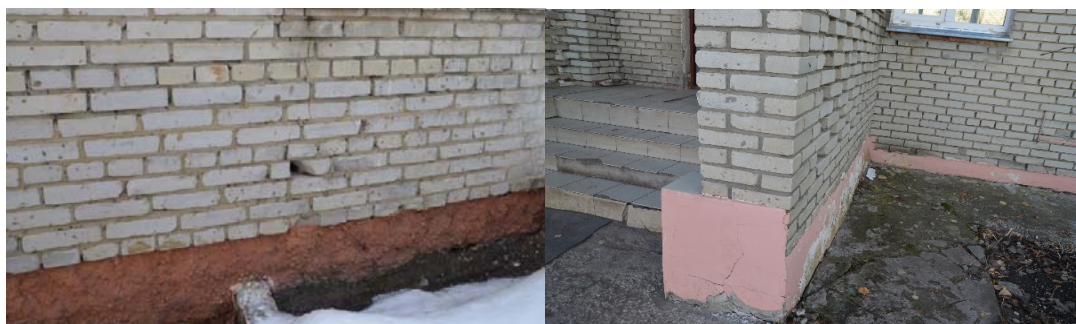
Рис. 6. Отмостка здания детского сада имеет многочисленные следы разрушений
