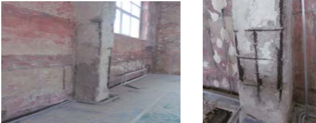
Рис. 11. В здании детского сада разрушение защитного слоя бетона колонны и коррозия арматурных рабочих стержней
