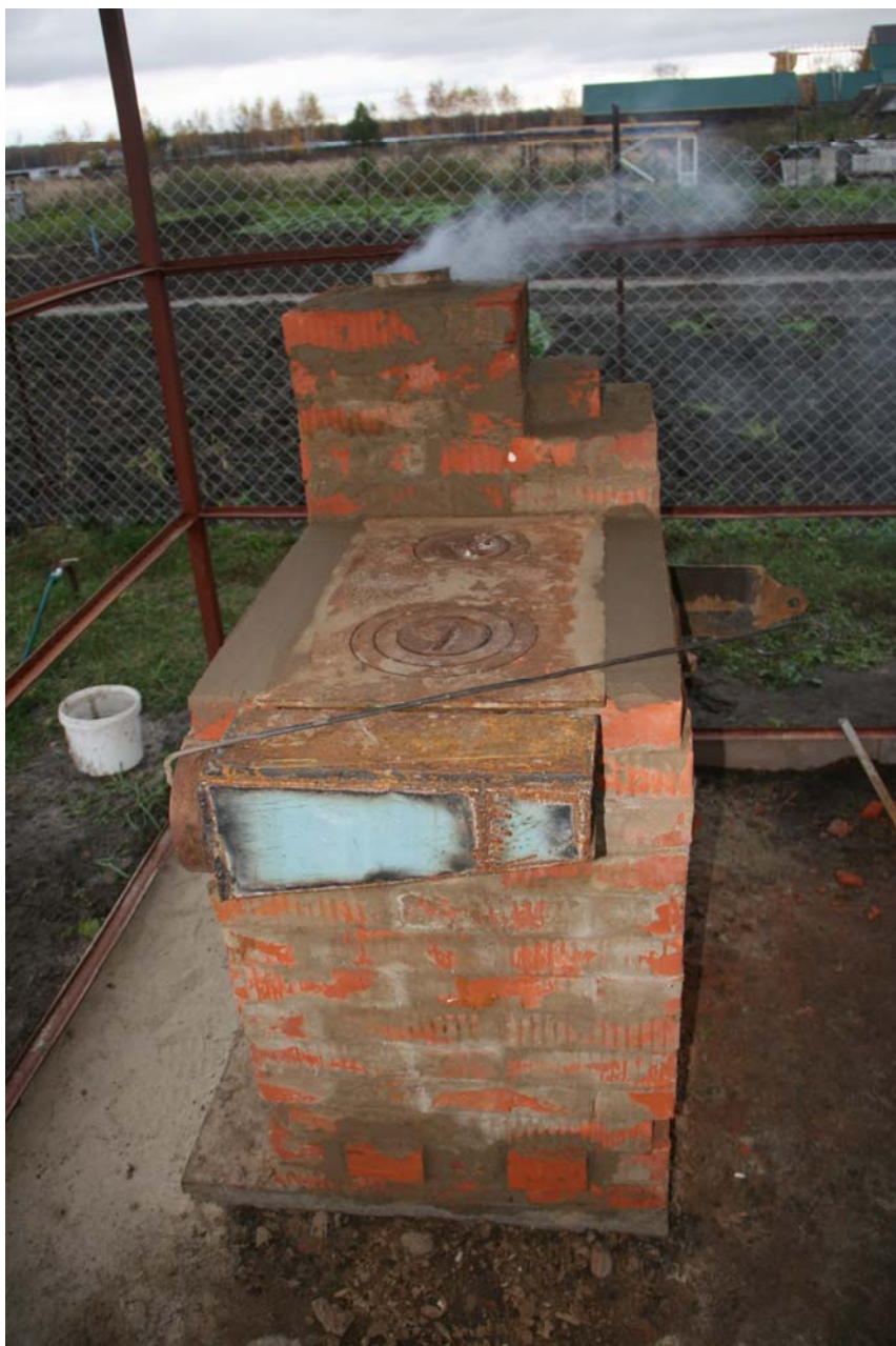
Рис. 3.9. Печь с теплообменником (общий вид)
