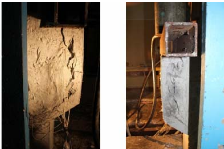
Рис. 3.14. Трещины в бетоне при нагрузке 147,15 кН (15 т)
