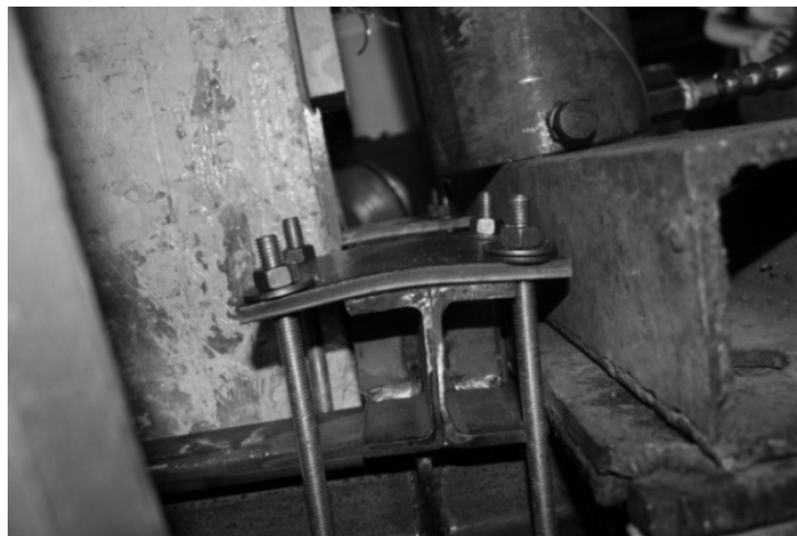
Рис. 3.27. Погибы опорных шайб и шпилек соединения
