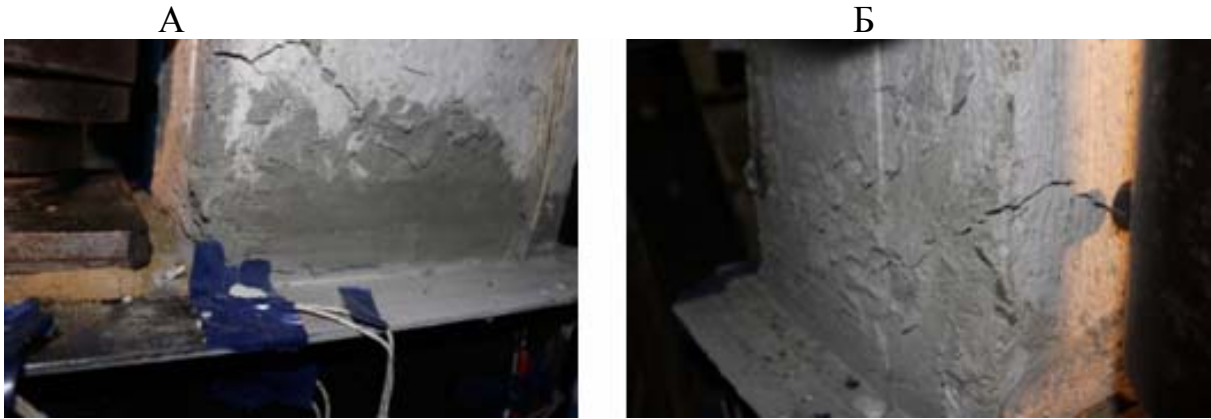
Рис. 3.37. Общий вид трещины со стороны консоли при силе 374,93 кН: А – вид справа на модель консоли; Б – вид слева
