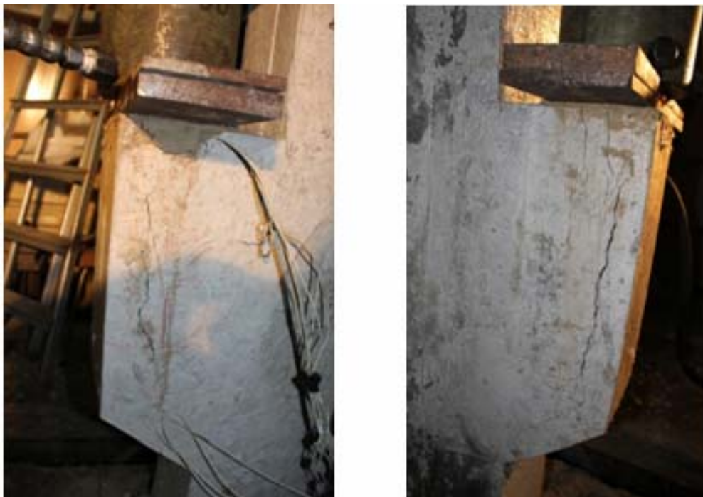
Рис. 3.13. Вид 1-й консоли колонны при разрушении
