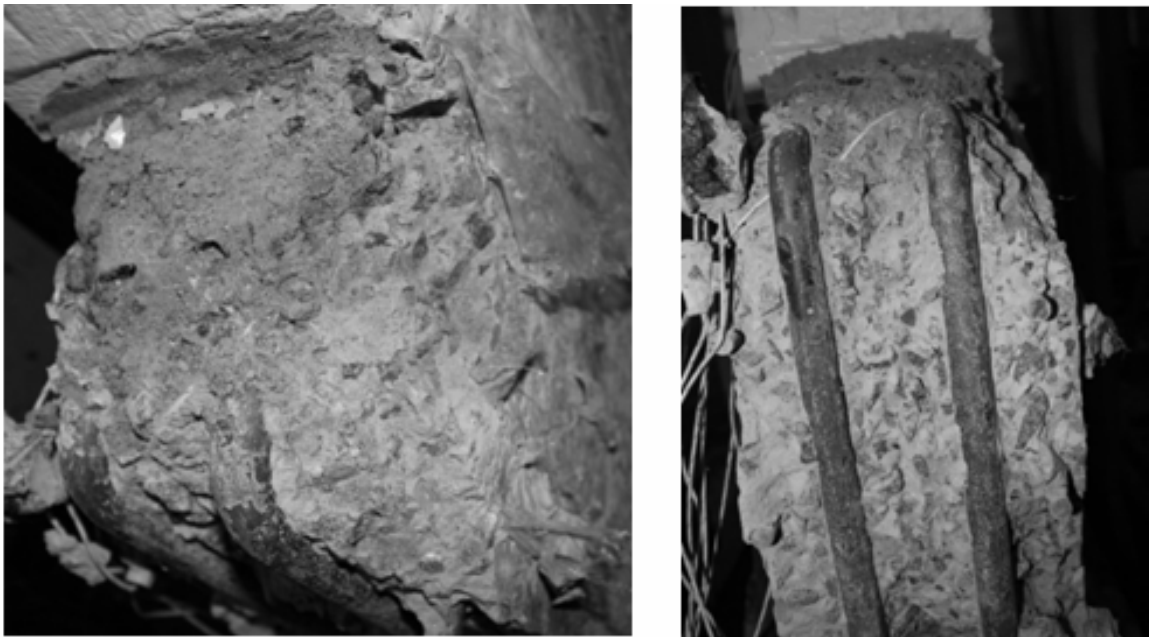
Рис. 3.31. Общий вид разрушения бетона консоли
