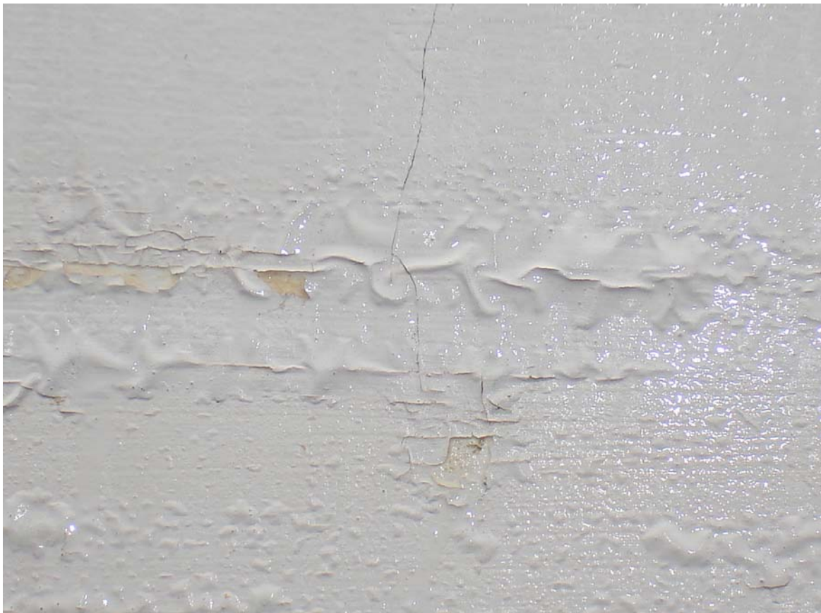
Рис. 5.19. Фотография фасада здания после трех лет эксплуатации известкового покрытия
