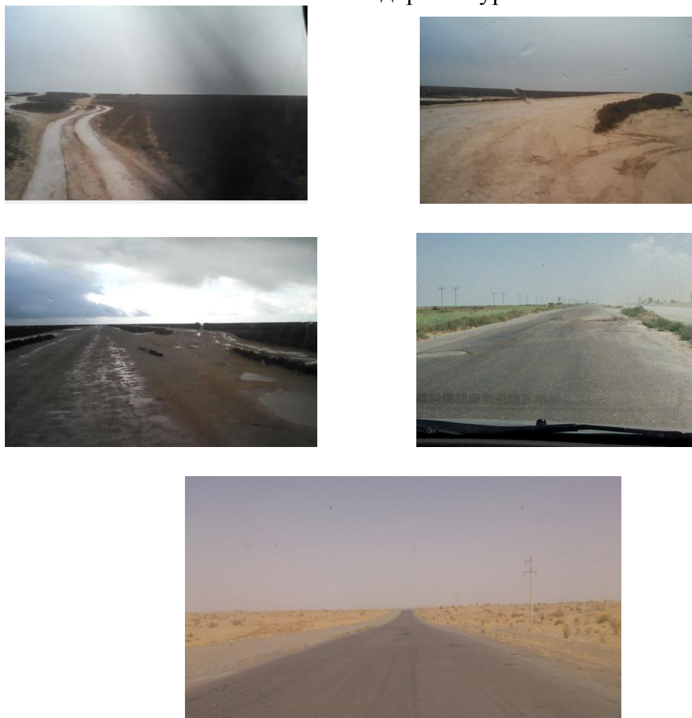
Фото 2.2 Состояние дорог между населенными пунктами
