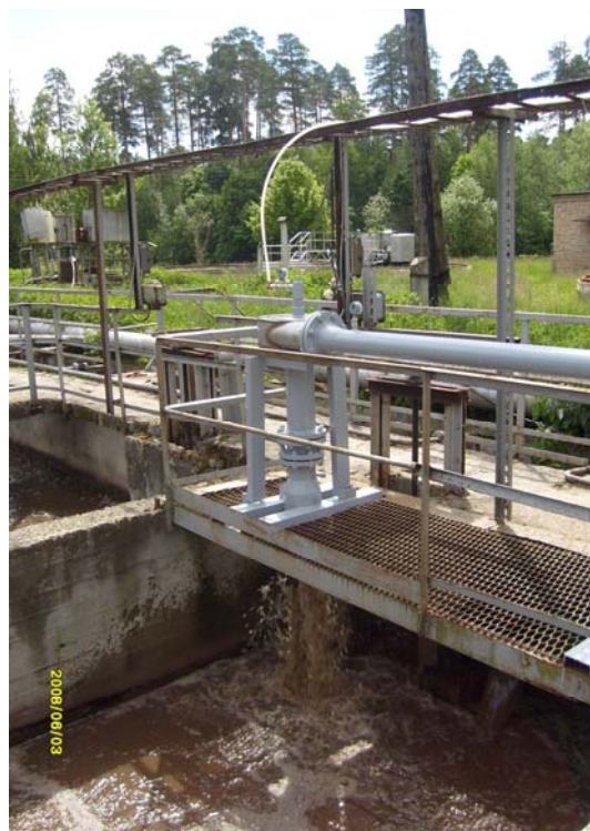
Рис. 5.3. Общий вид секции аэротенка КОС (г. Заречный, Пензенской области) с работающим ЭГДУ
