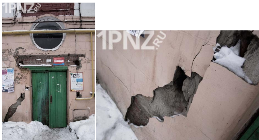
Рисунок 30 – Вид дома №11 по ул. 9 Января, не попавшего в Программу расселения 5
