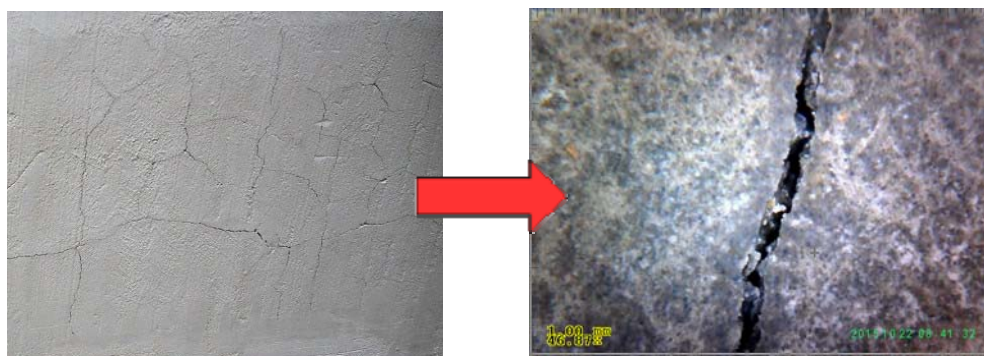
Рис. 6. Трещины на поверхности мелкозернистого бетона в результате действия пластической усадки
