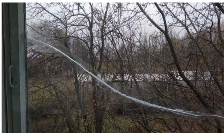
Рис. 2. Трещины стекла в школе Вадинского района Пензенской области
