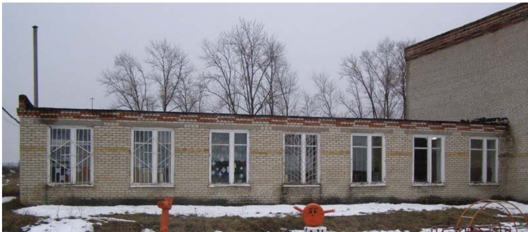
Рис. 1. Состояние окон в сельском доме культуры в Башмаковском районе Пензенской области
