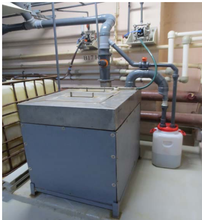
Рис. 2. Общий вид промышленной установки обезвреживания щелочных отработанных растворов травления печатных плат
