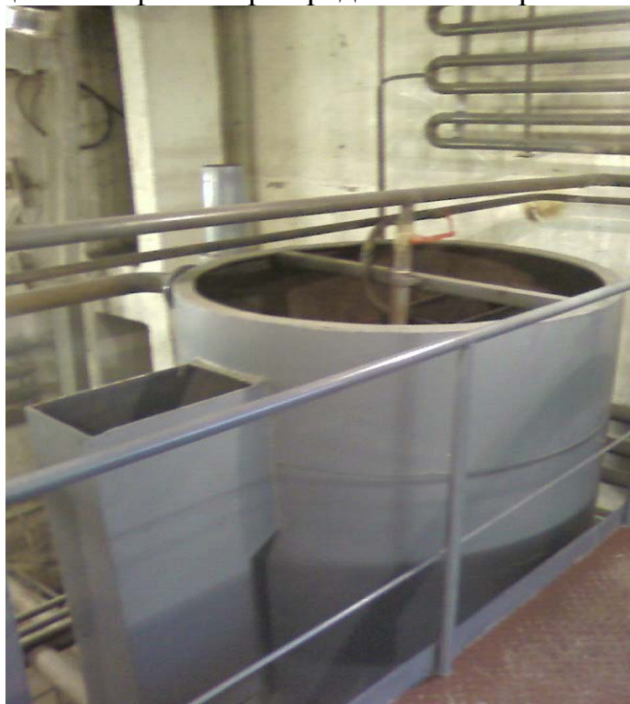
Рис. 5.2. Общий вид циклона-флотатора
