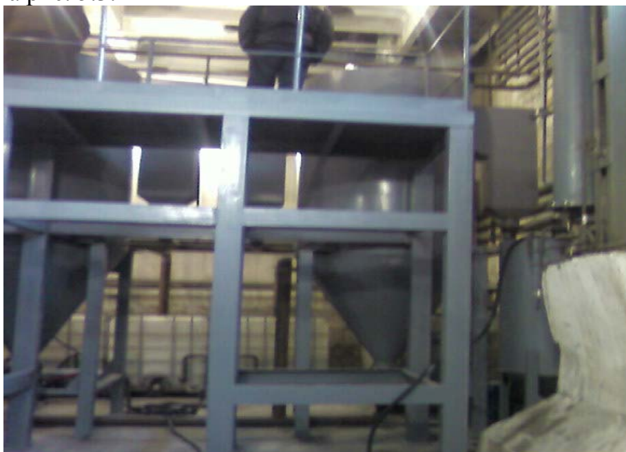
Рис. 5.3. Общий вид локальных очистных сооружений промывных сточных вод ОАО «Пензтяжпромарматура»
