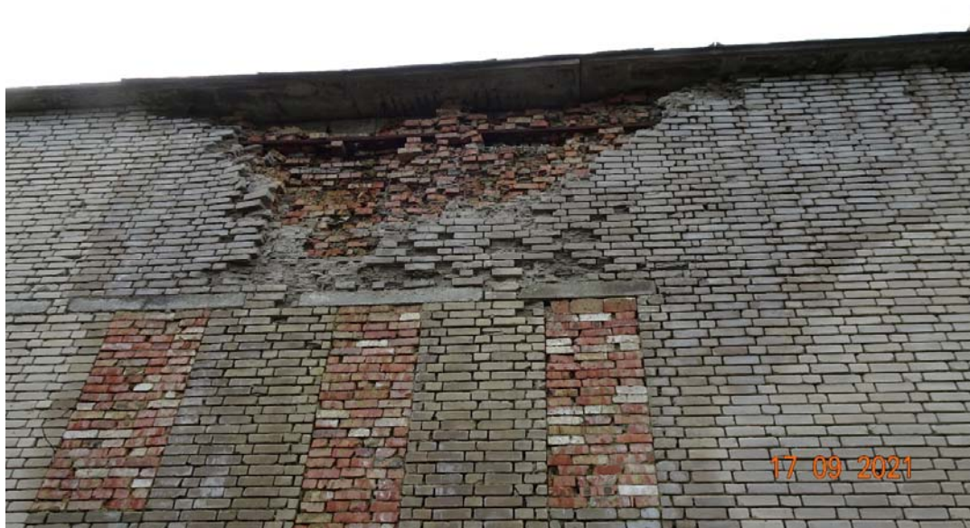
Рис. 4. Фрагмент разрушенной несущей стены зрительного зала
