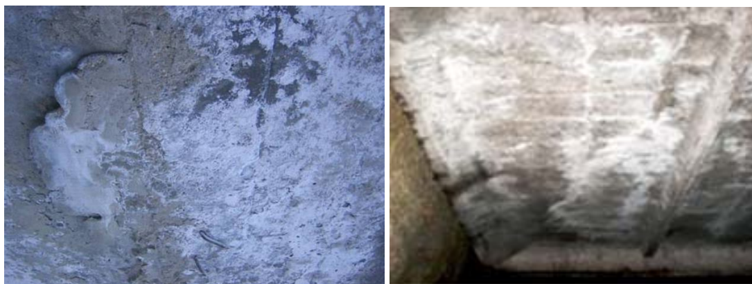
Рис. 3. Выщелачивание извести из бетона на монолитных участках сопряжения балок пролетного строения
