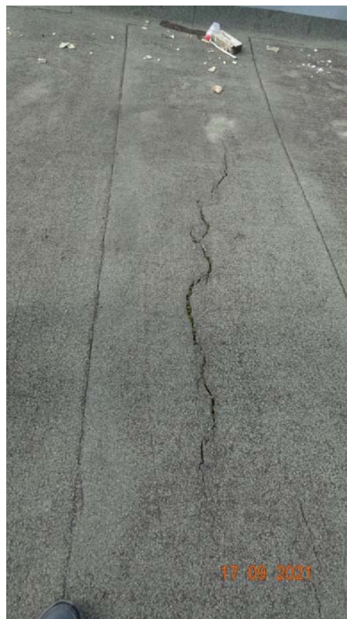
Рис.2. Трещина в рубероидном ковре длиной 6 м и шириной раскрытия до 15 мм над несущей стеной зрительного зала
