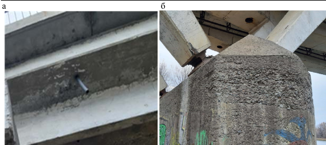
Рис. 2. Выщелачивание бетона: а – близ водоотводной трубки; б – на поверхности бетона массивной опоры (быка) (автодорожный мост, г. Пенза)
