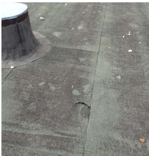
Рис. 1. Дефект стыка рубероидного ковра
