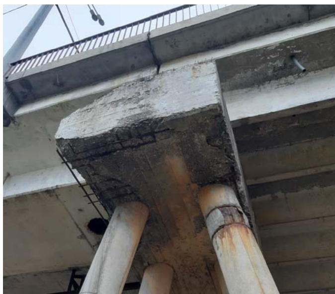
Рис. 1. Дефекты конструкции моста: разрушение защитного слоя бетона, скол, коррозия арматуры
