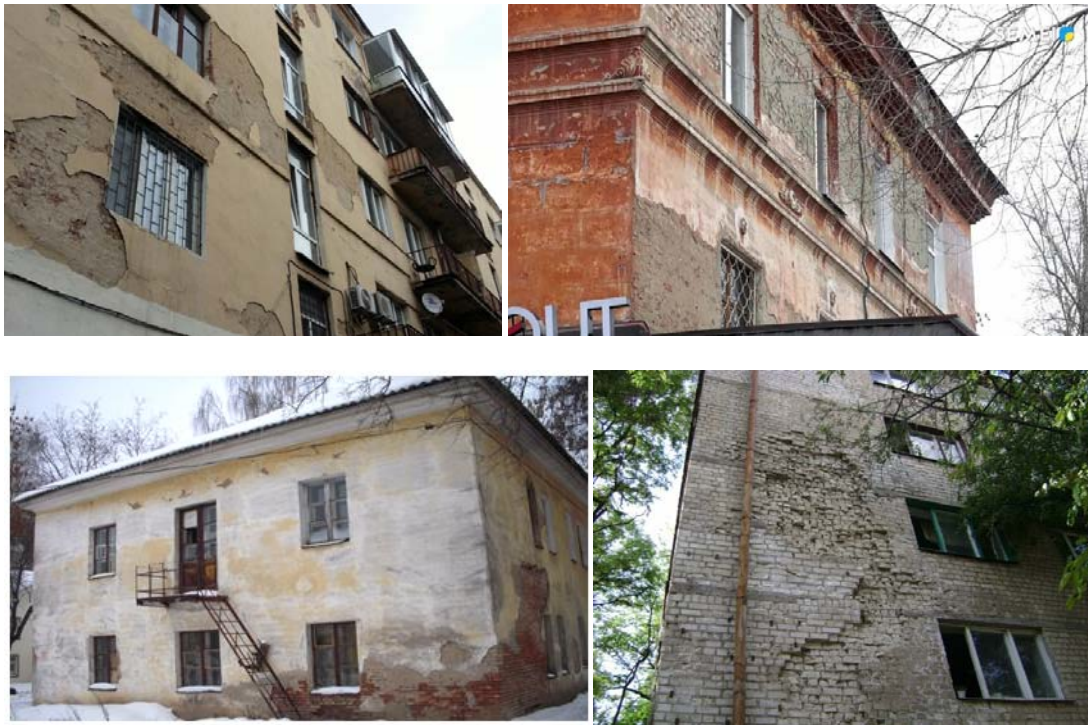
Рис. 4. Фрагменты фасадов зданий городской застройки, имеющих значительный физический износ
